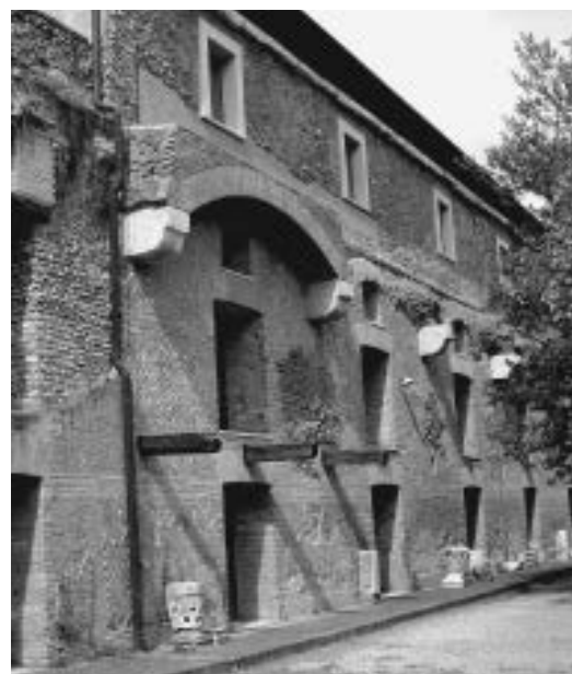
Fig. 2. Tivoli, Villa Adriana, edificio a nord-est del Canopo. Nel corso di un affrettato restauro, l'inequivocabile presenza di un ballatoio ha motivato l'inserimento di mensole in chiave d'arco (!) per sorreggerne le travature di sostegno. L'analisi basata sul rilievo della zona antistante, che ha messo in luce la presenza di fondazioni per pilastri in muratura, ha consentito un più coerente ripristino nel pieno rispetto della realtà antica.
