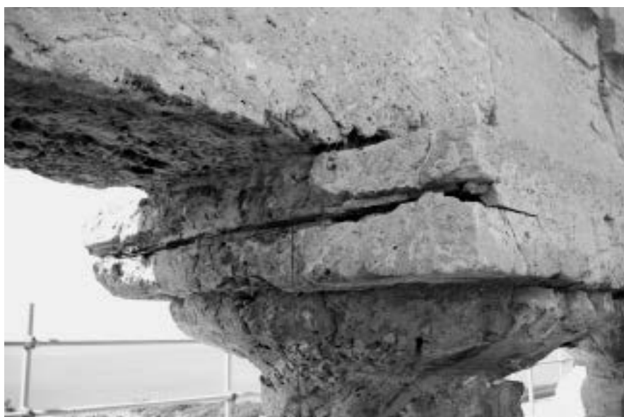
Fig. 7. Selinunte, tempio C, quinto capitello da est. Durante l'anastilosi, 1925-26, l'abaco è stato restaurato mediante inserzione di un telaio in tondino di ferro, ricoperto di malta cementizia; nel corso di un intervento di restauro effettuato dal 1978 al 1981 l'intero capitello è stato consolidato con iniezioni di resine epossidiche, ed i giunti sigillati con resina gommosa.
